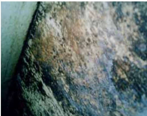
船体劣化状況(裏板)
