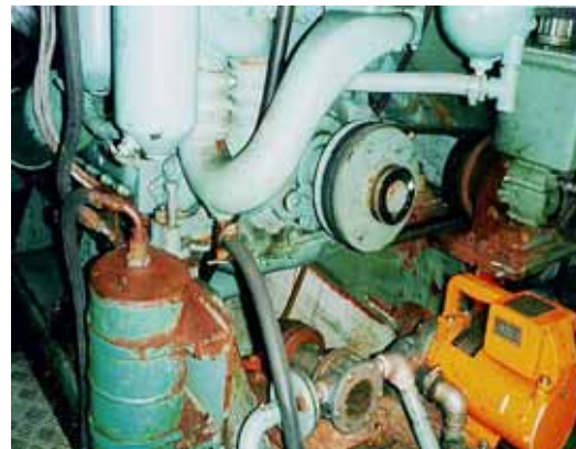
主機関劣化状況
